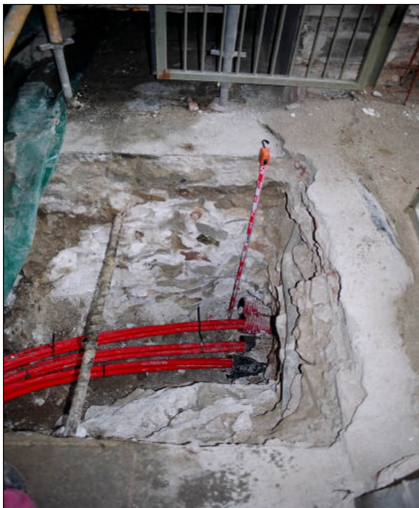
Fotografia on es pot apreciar el gruix de la fonamentació del mur de façana de la finca número 1 del carrer Sant Honorat
